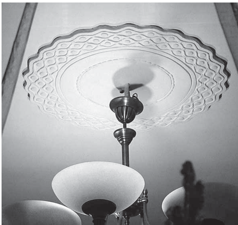
Ilustracja 1-53. Fragment wystroju sztuka-torskiego w jednym z lokali mieszkalnych wewnątrz kamienicy przy Alejach Jerozolimskich 99, stan z 2017 roku. Fot. P. Kilanowski
