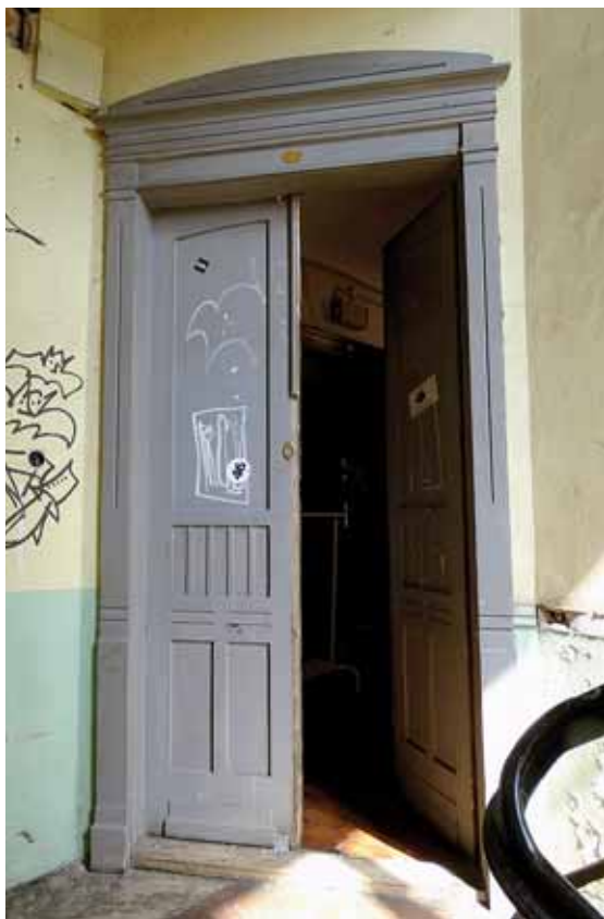
Ilustracja 1-22. Drzwi wejściowe do jednego z lokali na głównej klatce schodowej w kamienicy przy Alejach Jerozolimskich 57, stan z 2017 roku. Fot. P. Kilanowski
